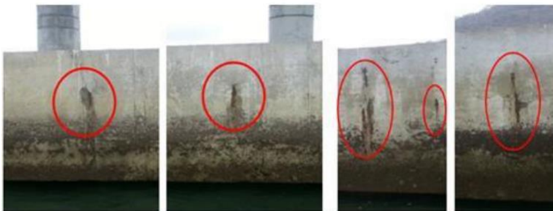
Figura 1. Fenómeno corrosivo evidente en el hormigón
