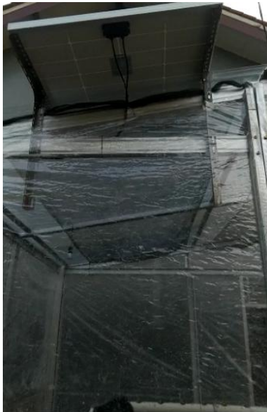
Gambar 11. Panel Surya Pada Green House
