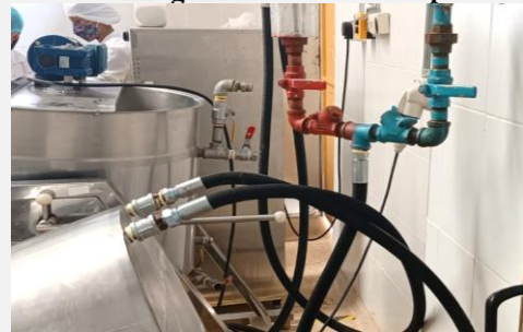
Imagen10. Valvula de vapor
