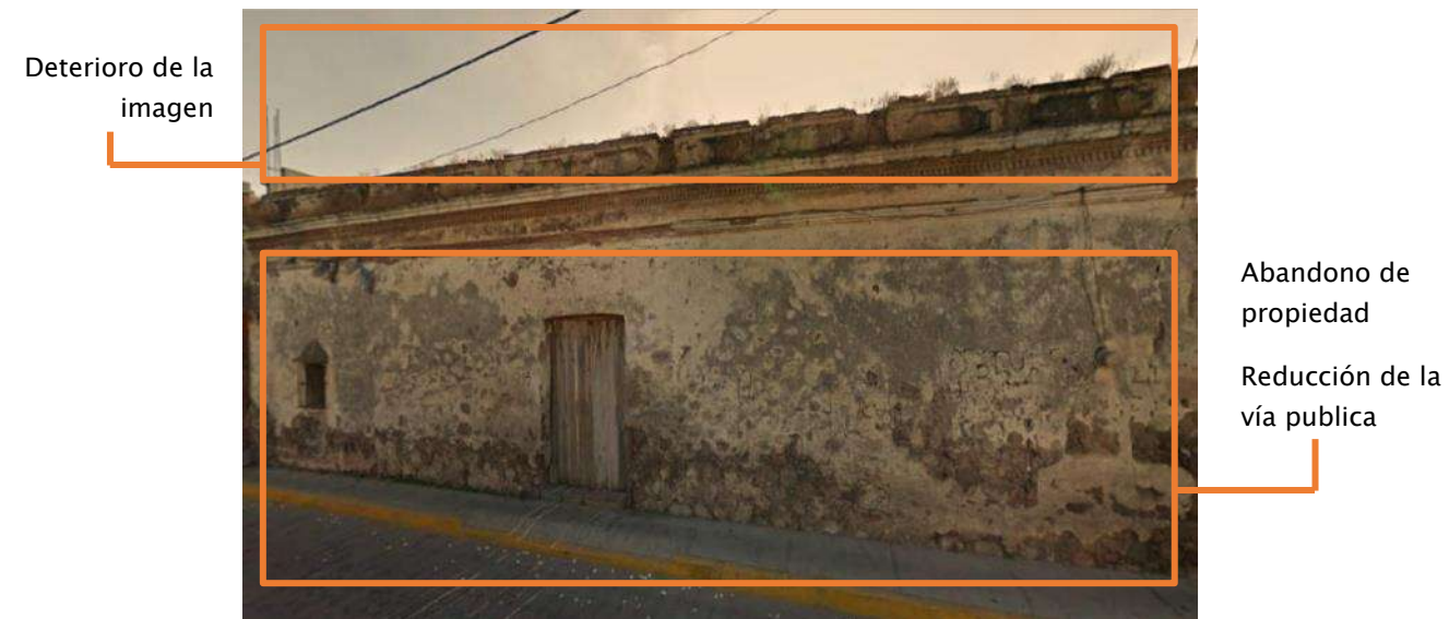
Ilustración 254; Representación de daños 4, Calle Xicohtencatl Norte (2020)
