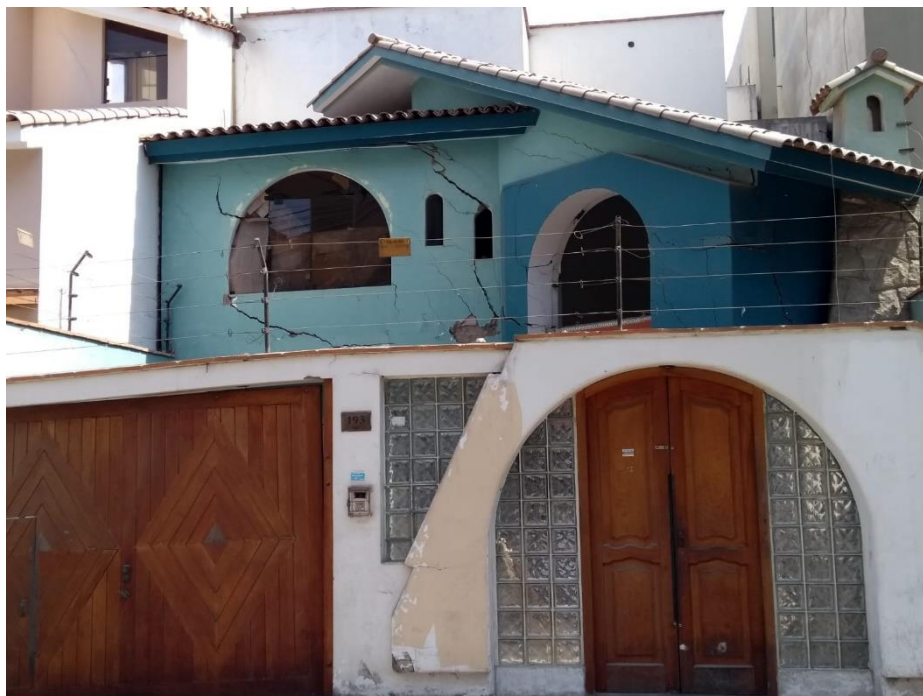
Figura 121. Vivienda con grietas al borde del colapso. Fuente: Elaboración Propia.
