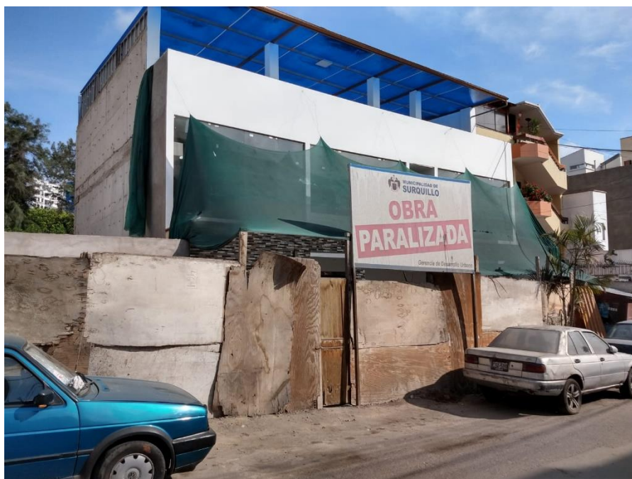
Figura 124. Obra Paralizada en Residencial Limatambo. Fuente: Elaboración Propia.
