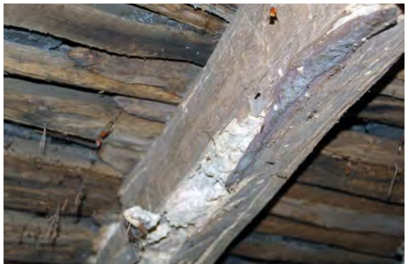
Figura 5 Travatura principale vistosamente attaccata da insetti xilofagi e funghi di caria bianca. La capacità strutturale di resistenza risulta compromessa.
