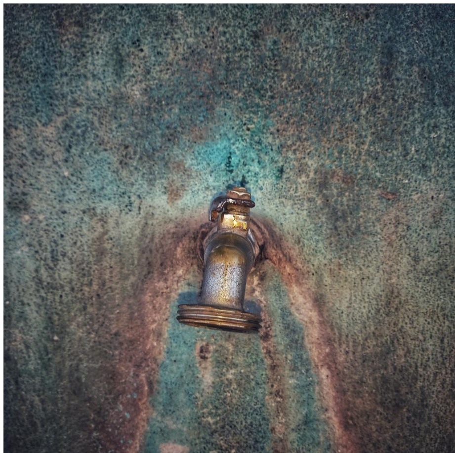
FIGURA 3: VANDALISMO A CANILLAS
