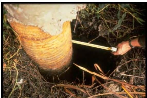
Slika 16.. Autoput 1 Natputnjaka Struve Slough blizu Watsonville srušio se tokom Loma Pijeta zemljotresa 1989, sa probijanjem putne ploče šipovima. Foriranje zazora-otvora oko 1 od šipova. Prema Meymond 1998.
