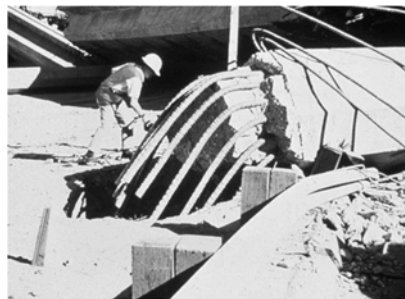
e) Slom usled izvlačenja nastavljene armature iz temelja. e) Lap-splice failure.
