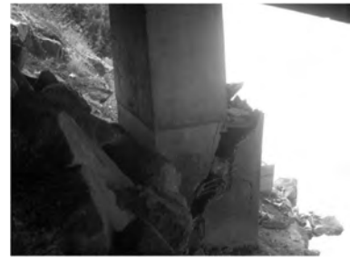
c) Smičući lom stuba, usled graničnog duktilnog ponašanja. c) Column shear failure
