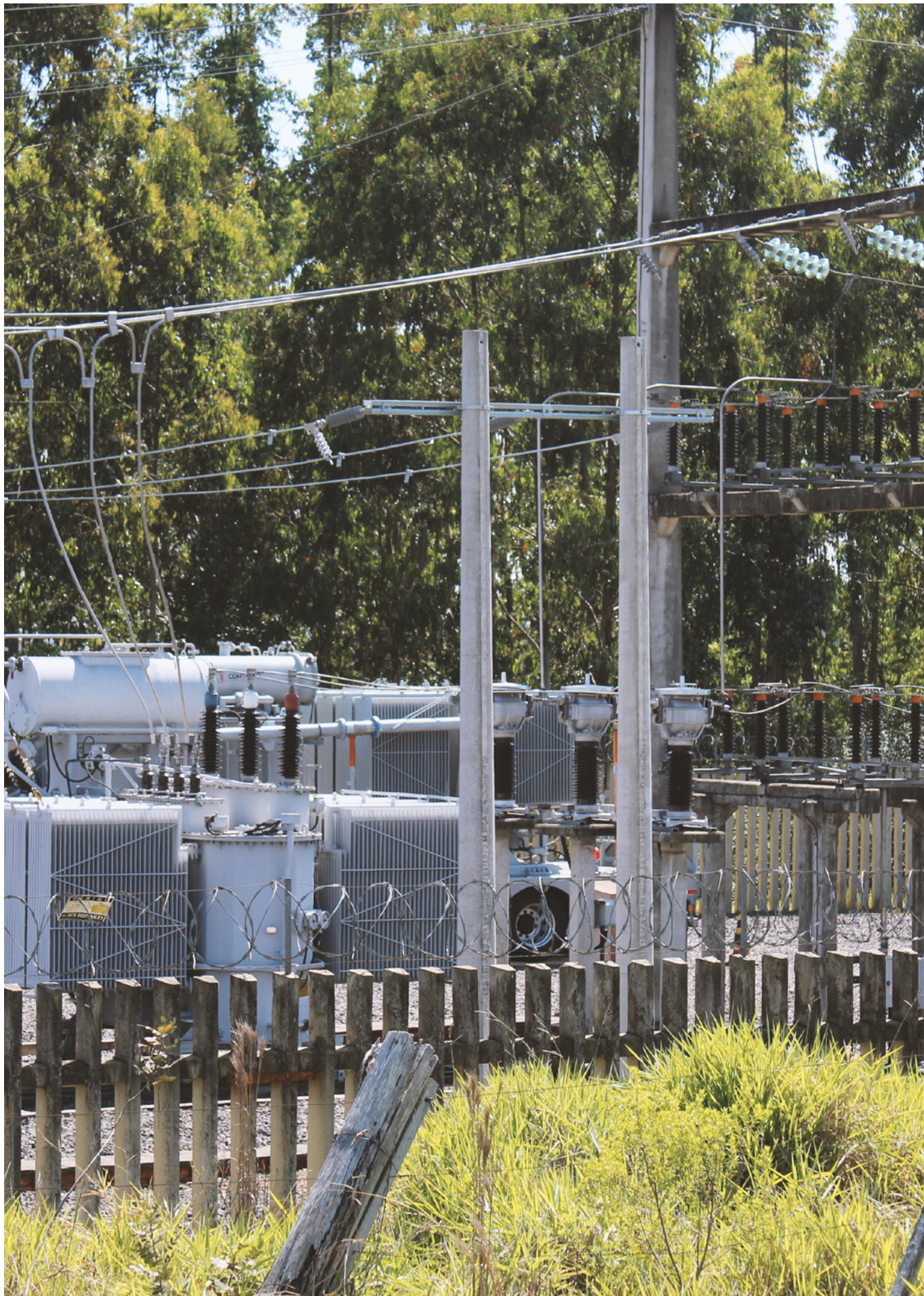
Fig. 15 - Central de distribuição de energia, Tapera Queimada, Triunfo (RS), 2020. Fonte: Autor.
