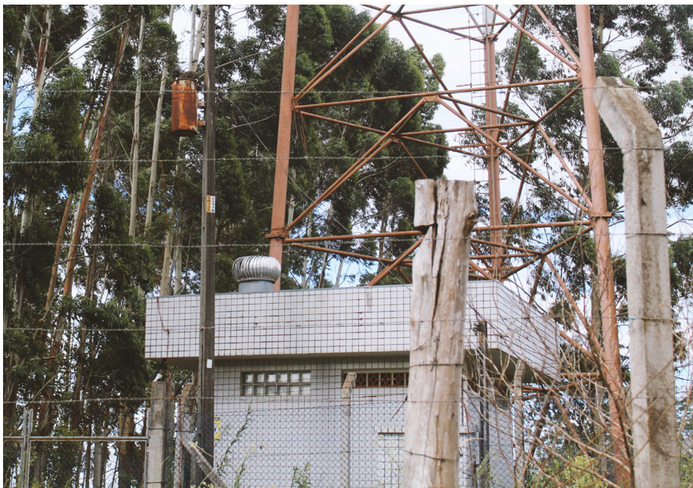
Fig. 16 - Torre de antena telefônica, Fazenda Quadros, Montenegro (RS), 2021. Fonte: Autor.
