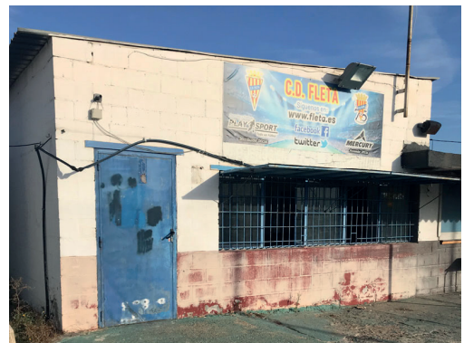
Figura : Foto previa a las actuaciones de Z.DIC21, (Vectuario CDM Fleta). Proyecto de Demolición Z.DIC21
