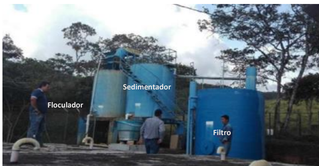
Figura 6. Planta de tratamiento de agua potable floculador, sedimentador y filtro.
