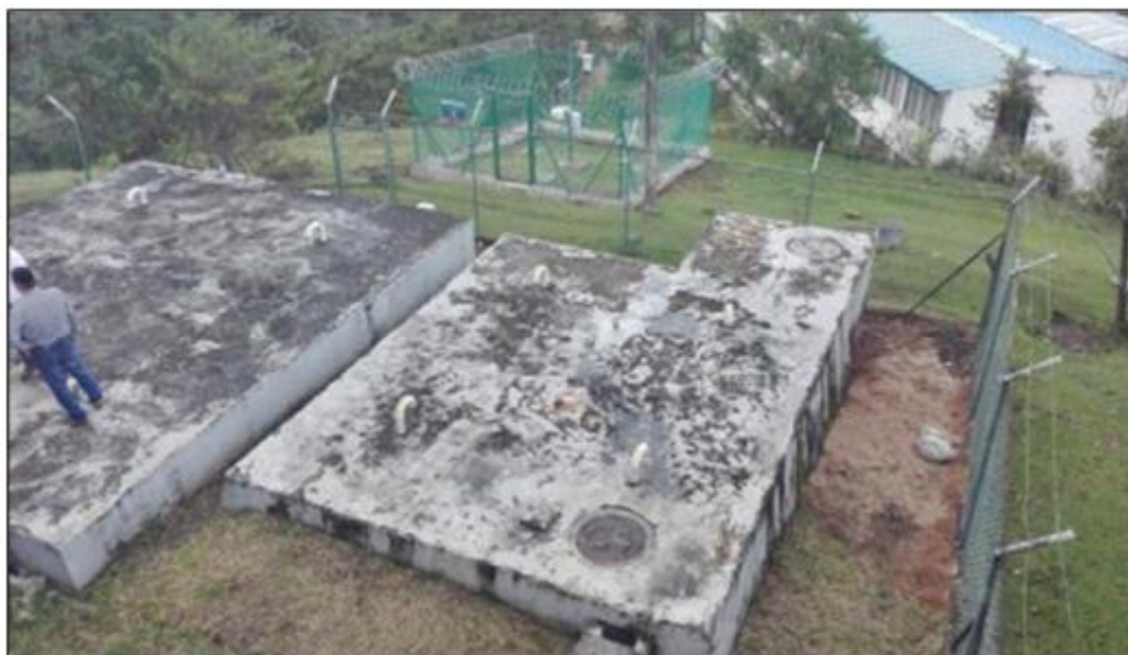
Figura 7. Tanques de almacenamiento de agua tratada
