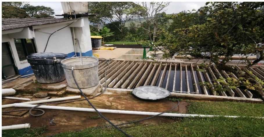
Figura 7. Proceso de floculación con canales rectangulares en concreto.
