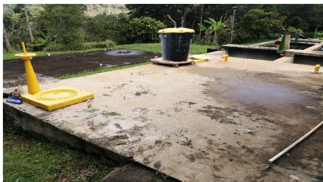
Figura 10. Proceso de cloración.
