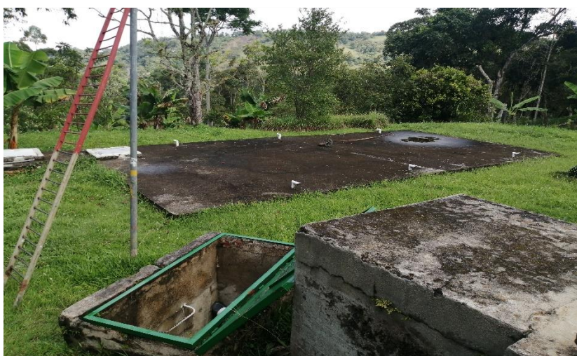
Figura 11. Tanques de almacenamiento.
