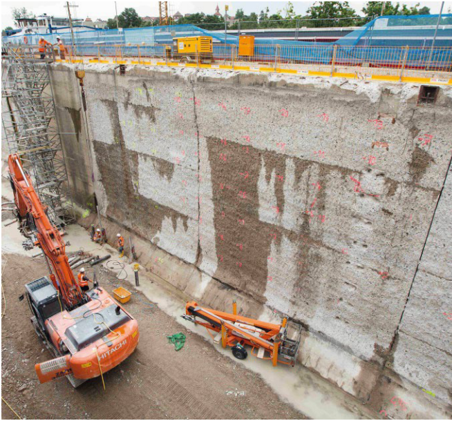
Bild 3: Unbewehrte Schleusenammerwand mit austretendem Riss- und Porenwasser nach Abtrag der Betonoberfläche anlässlich einer Betoninstandsetzung Unreinforced lock chamber wall with leaking crack and pore water after removal of the concrete surface during concrete maintenance
