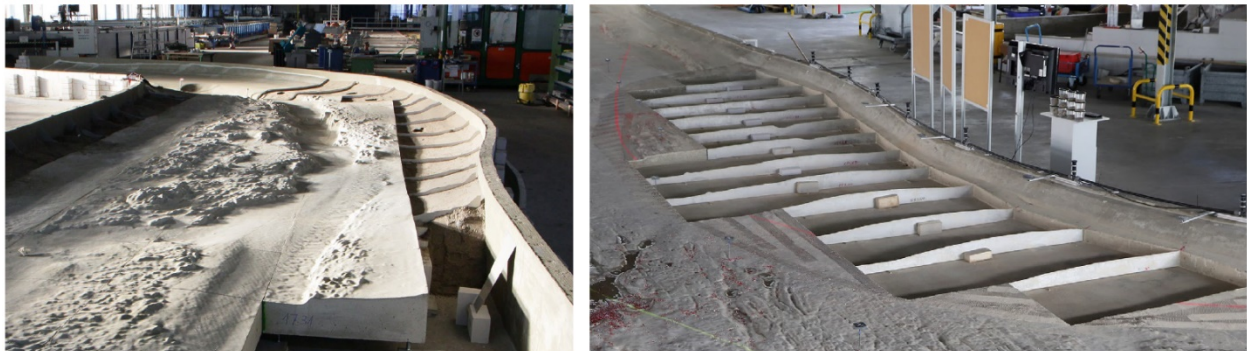
Bild 6: Links: Modellaufbau, Betongussblöcke und Randbereiche in Profilbauweise, rechts: Herstellung des Kiesbank-Koffers mit herausnehmbaren Blechprofilen für variable Nutzungen. (Quelle: BAW)
