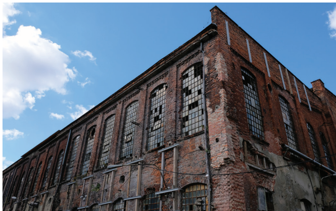
Fotografia 1. Zdegradowany budynek pofabryczny
