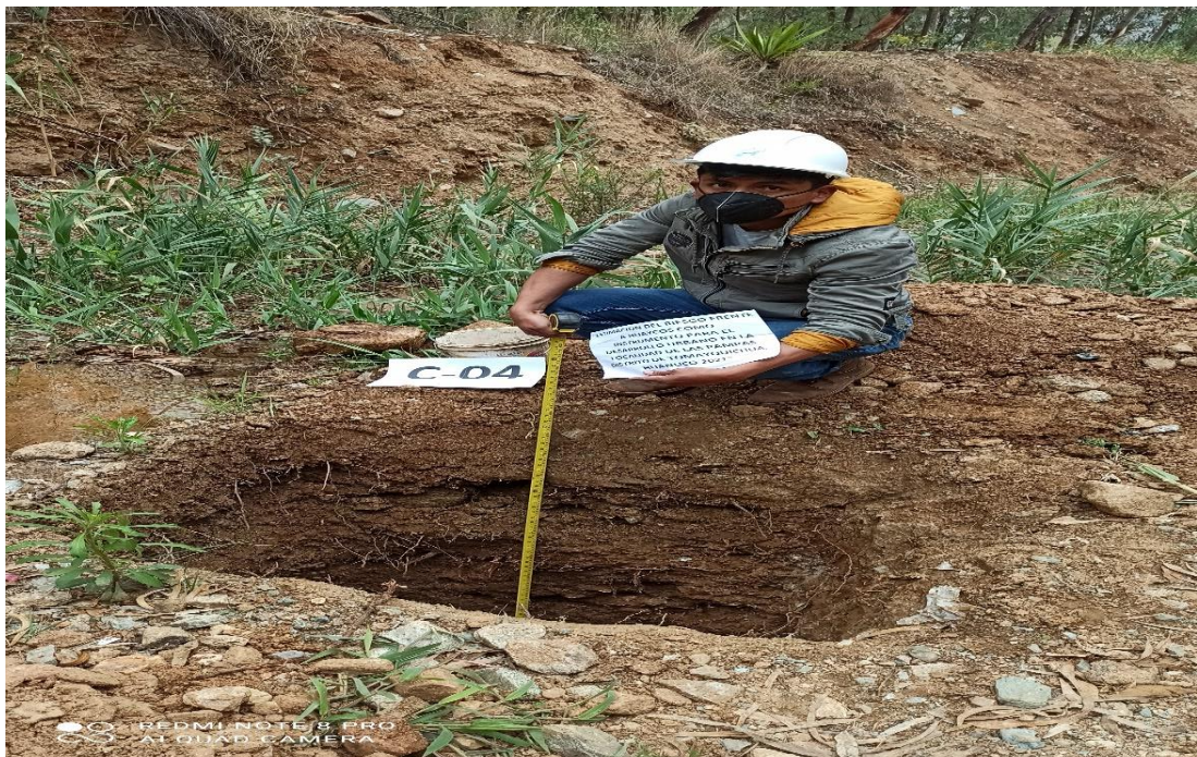
En la imagen se observa la excavación de zanja que viene hacer la calicata N° 04.
