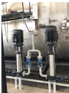
Figura 46: Bombas da caldeira
