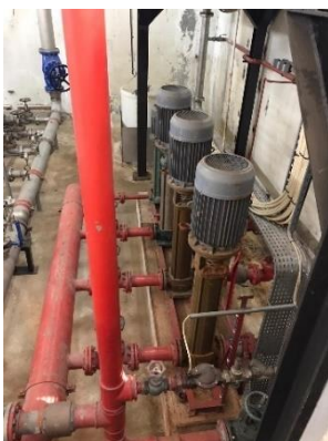
Figura 45: Bombas da rede de incêndio
