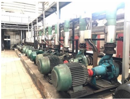
Figura 42: Bombas de circulação de água gelada
