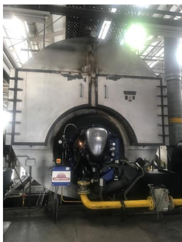
Figura 39: Caldeiras a gás
