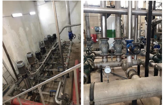
Figura 43: Bombas de circulação de água fria
