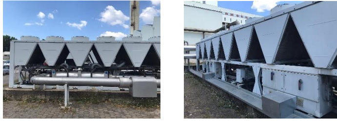
Figura 41: Chillers Elétricos a) Vista Lateral b) Vista Frontal
