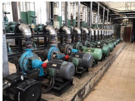
Figura 44: Bombas de circulação de água quente
