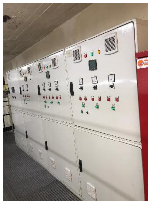
Figura 48: Quadro elétrico do variador de frequência
