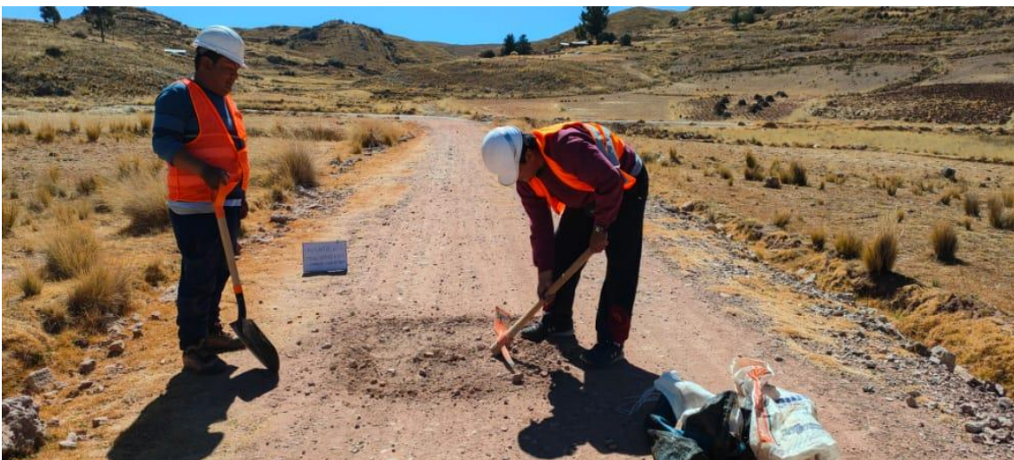
Fotografía 2. Selección del sitio para la calicata 02 en el tramo 00+750, carretera Cochiraya - Huayrapata.
