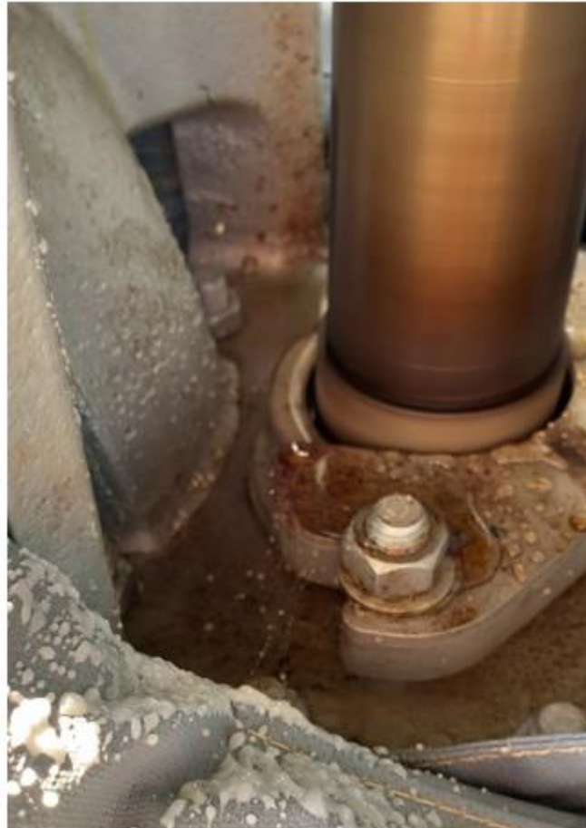
Abbildung 61: Salzleckage durch den Ringspalt zwischen Packung und Antriebswelle.
