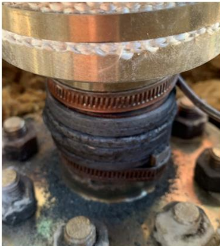
Abbildung 60: Defekte und poröse Ventilspindelheizung nach Überhitzung.
