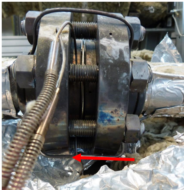
Abbildung 23: Flansch-2 nach dem Drucktest TK1/V2/R3; Es sind leichte Flüssigsalzreste an der Isolierfolie unten links zu erkennen (siehe roter Pfeil).
