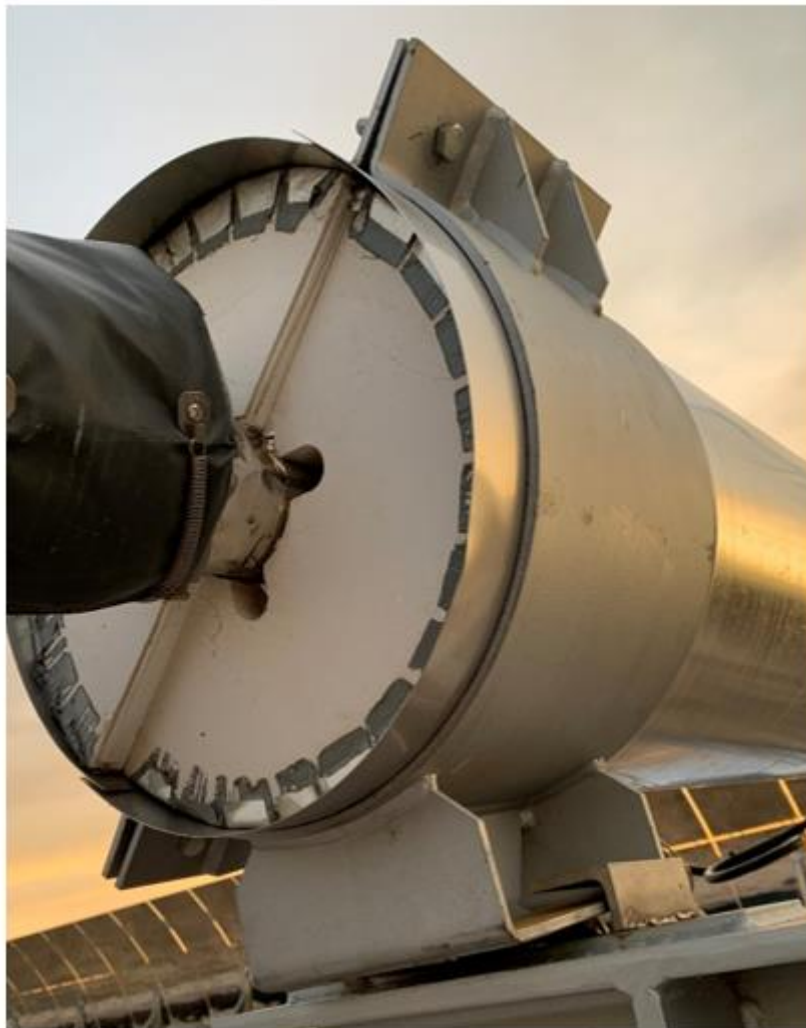
Abbildung 58: Rohrhalter mit Calciumsilikat Halterung und Rohrschelle. Übergang der Isolierungen wurde bei Installation nicht vollständig fertiggestellt.
