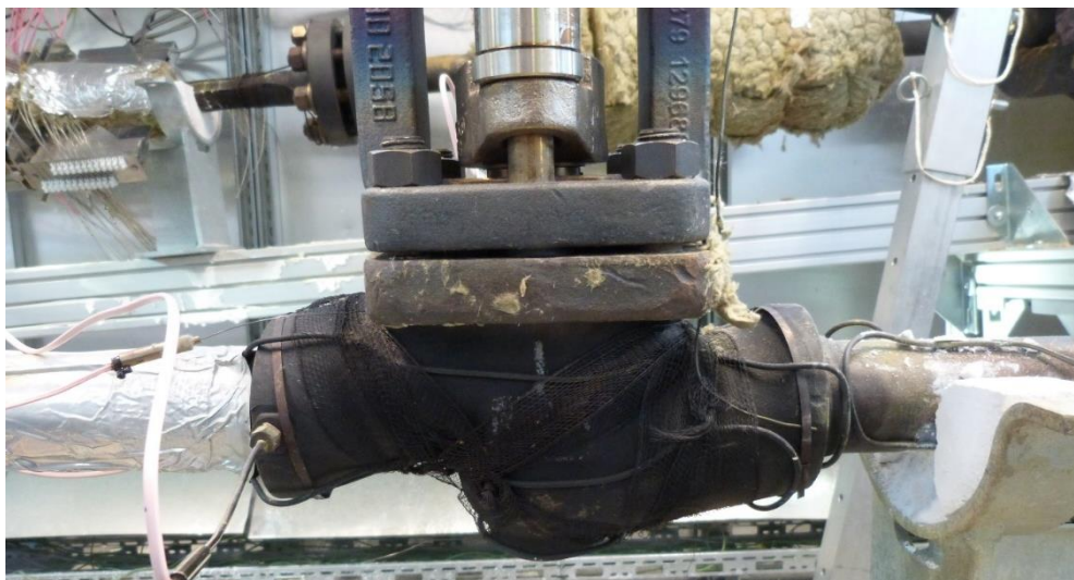
Abbildung 32: Begleitheizung am pneumatischen Ventil (V2).
