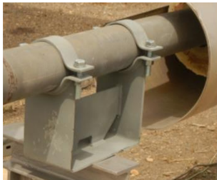
Abbildung 2: Rohrleitungshalterung mit Rohrschellen auf einer Stütze auf einem Gleitelement Typ „LISEGA“.
