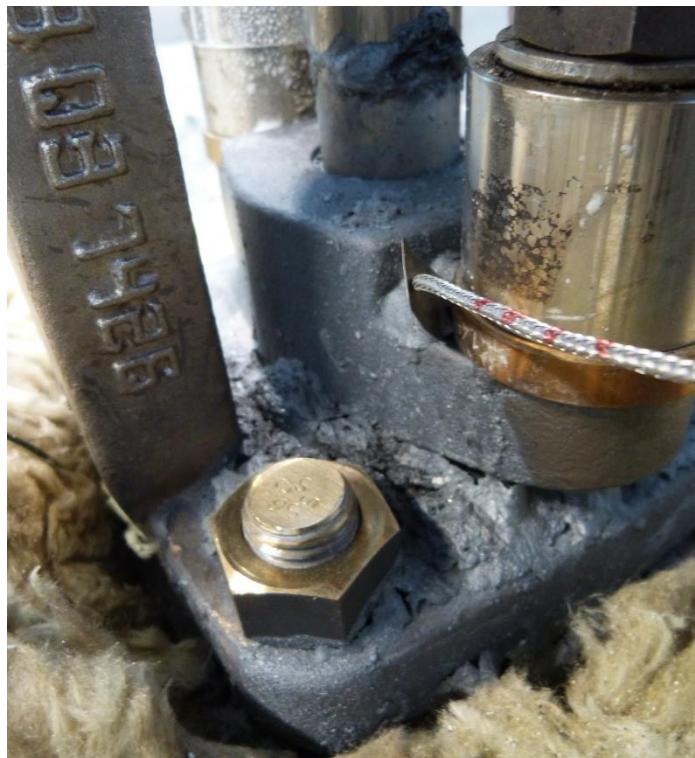
Abbildung 41: Zerstörte Graphit-Dichtung an der Ventilpackung.
