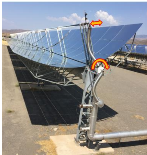
Abbildung 3: Flexible Rohrverbinder in Parabolrinnenkollektoren nehmen Expansionsbewegung (Pfeil oben) und Rotationsbewegung (unten) auf.
