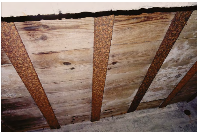
Il. 10. Wnętrze jednego ze schronów typu Regelbau 668 koło Przymiłowic w gminie Olsztyn; KOO 07_B3. Widoczne doskonale zachowane deskowanie przeciwoodpryskowe (antyrykoszetowe) stropu. Fot. J. Trajdos, luty 2019 r.
