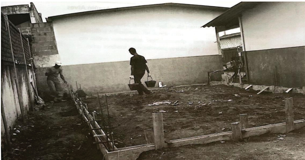
Figura 4: O início da construção da “Sala da Filosofia” no espaço da EM Pedro Rodrigues do Carmo 28
