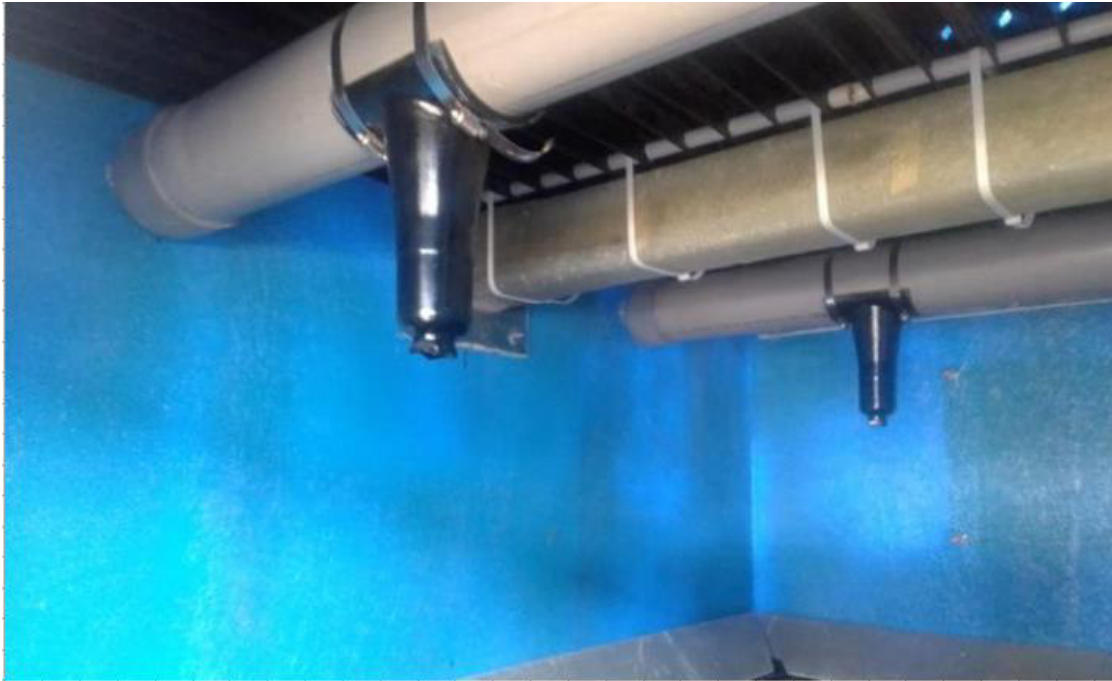
Figura 13. Tubos de distribución
