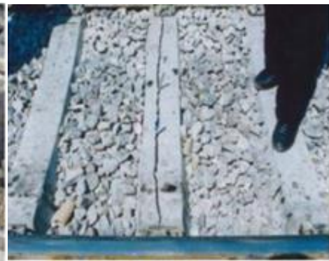
(b) longitudinal crack (Rezaie et al., 2012)
