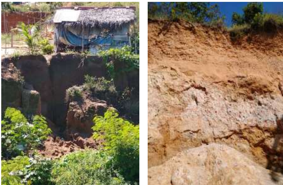
Figura 7a e 7b – Movimentos de massa, queda de bloco e deslizamento
