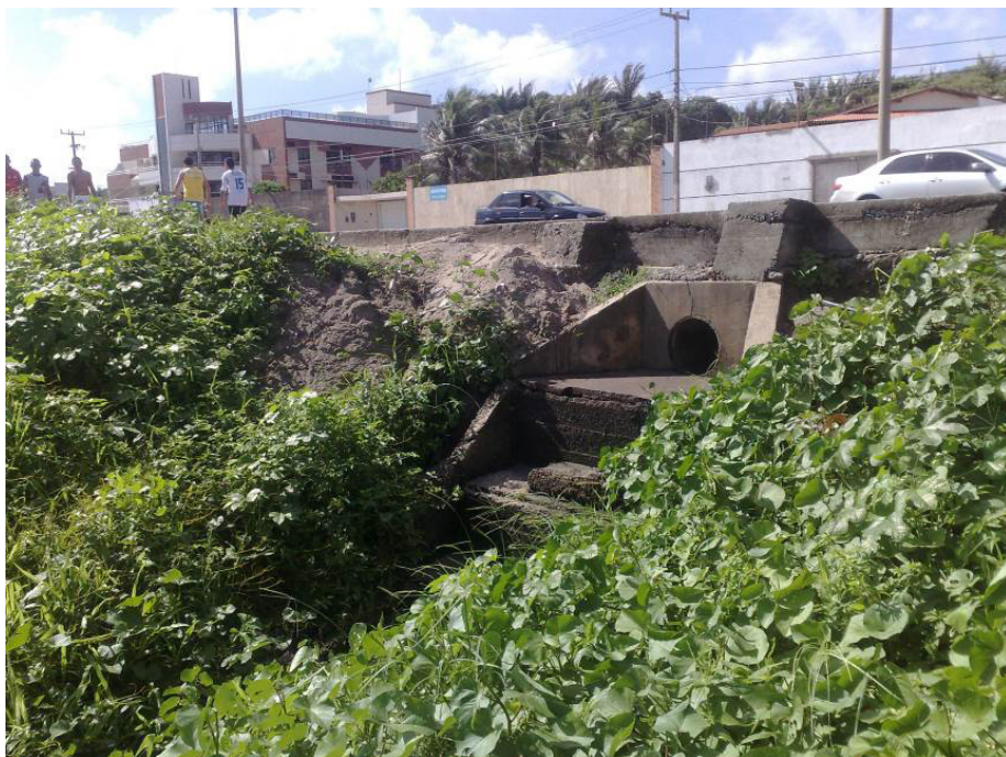
Figura 6 - Despejo de esgoto dos condomínios e residências na praia.
