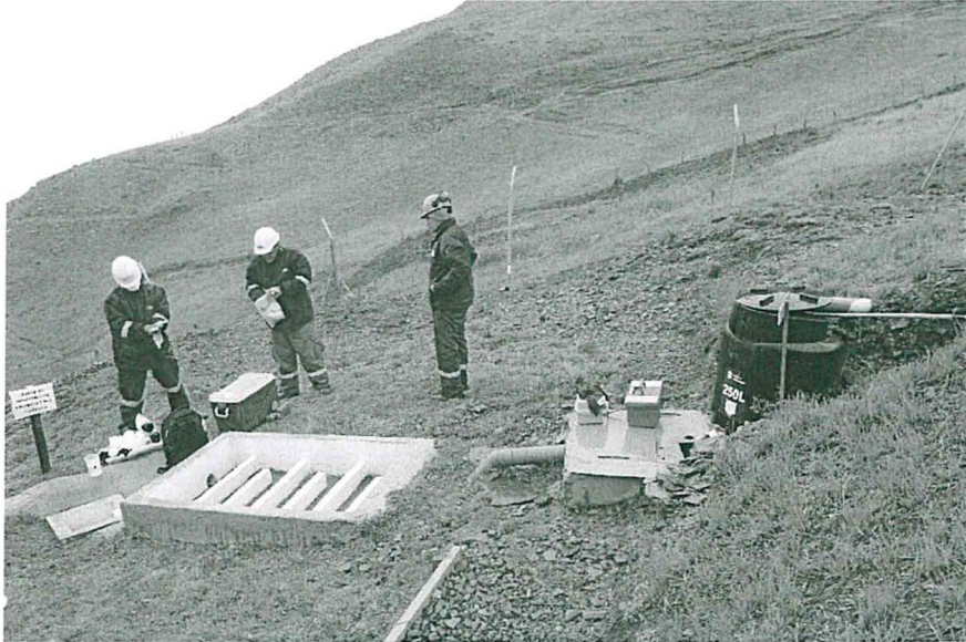
Fotografía N° 5. Área de las instalaciones de la PTARD del campamento PS4
