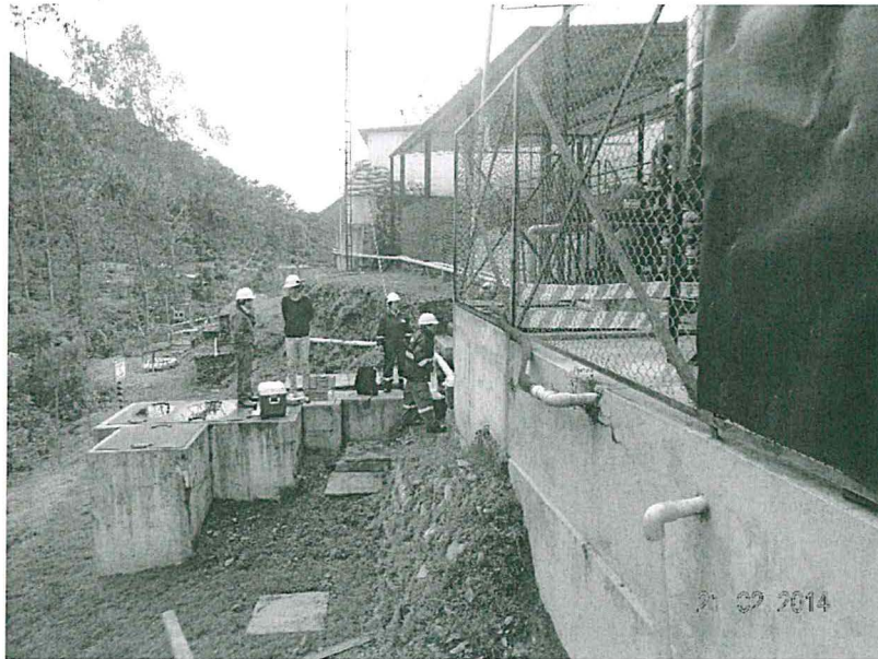
Fotografía N° 1. Área de las Instalaciones de la PTARD del campamento PS3
