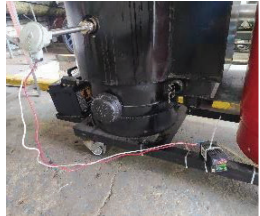
Foto 3. Sistema de registro de temperatura en reactor
