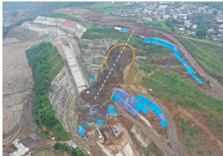
Gambar 2. Kondisi Longsoran Lereng Kiri Pelimpah Bendungan Ciawi
