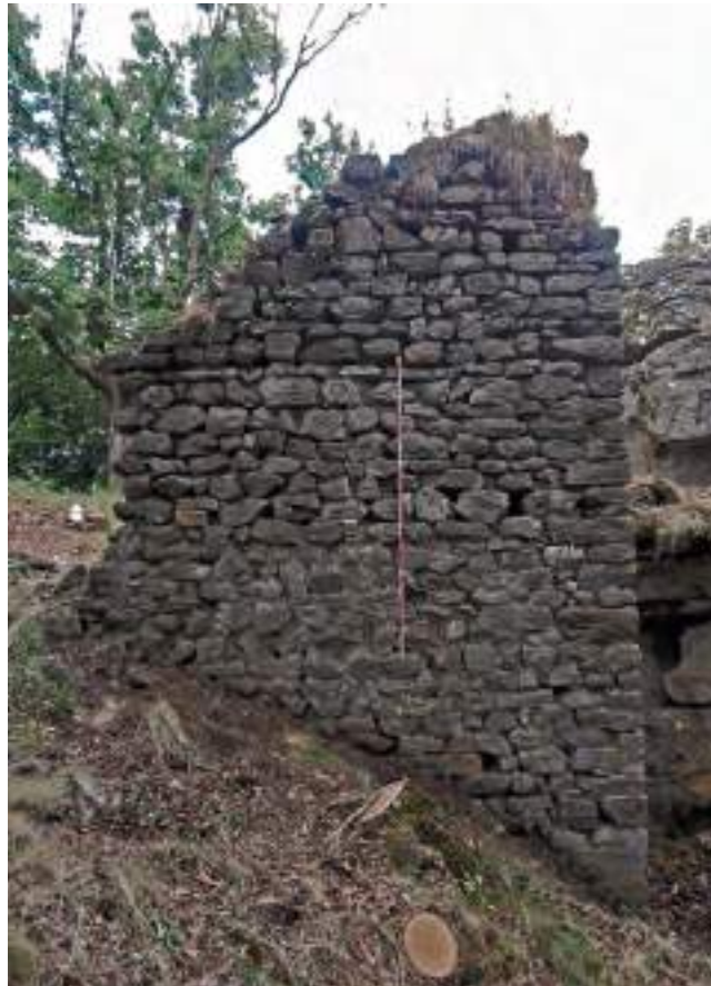
fig. 2 – Bagnasco (CN), sito di Santa Giulitta: torre sommitale, elevato esterno a destra dell'ingresso.
