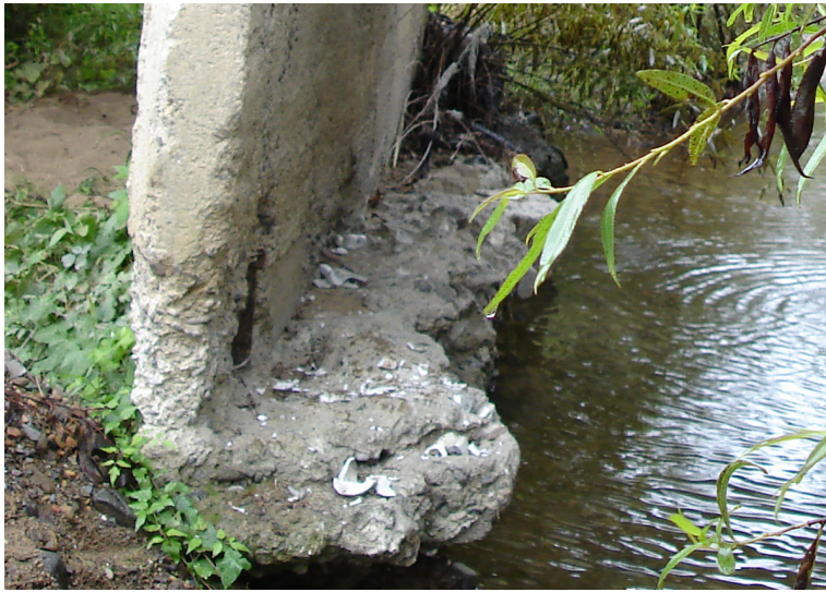
Slika 1 Degradacija betona usled dejstva vode i mraza
