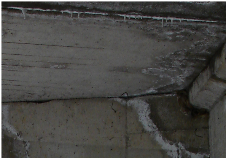
Slika 2 Degadacija betona usled dejstva soli
