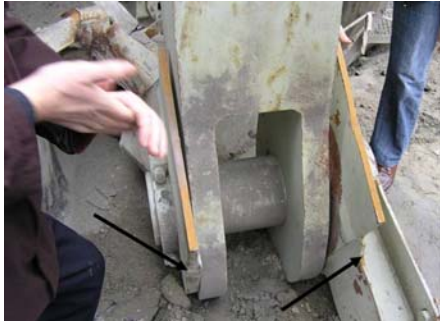
Figure 17. Fracture of two lugs caused the rotor excavator collapse. Slika 17. Lom dve uške izazvao je kolaps rotornog bagera
