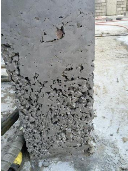
Ilustración 5 Segregación en Elementos estructurales Fuente: INA Construcción
