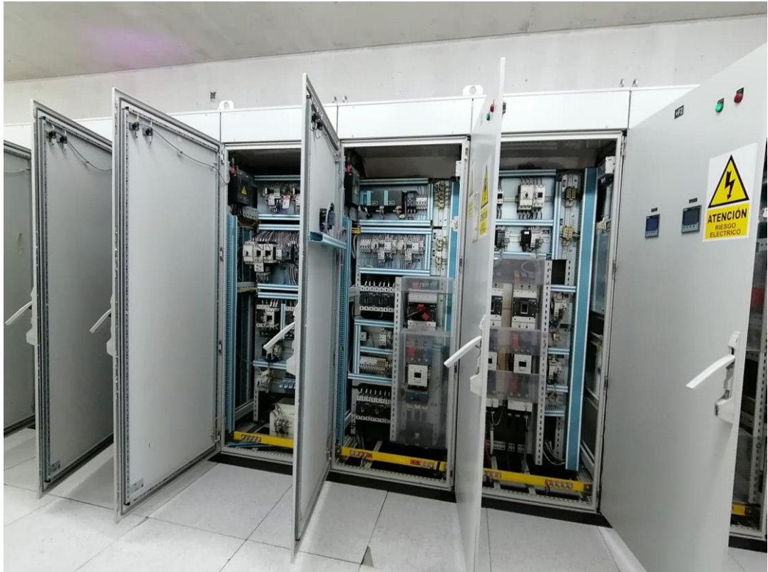
Figura 38: Vista Frontal de CCM- Cribado [CAROB Energy Perú]
