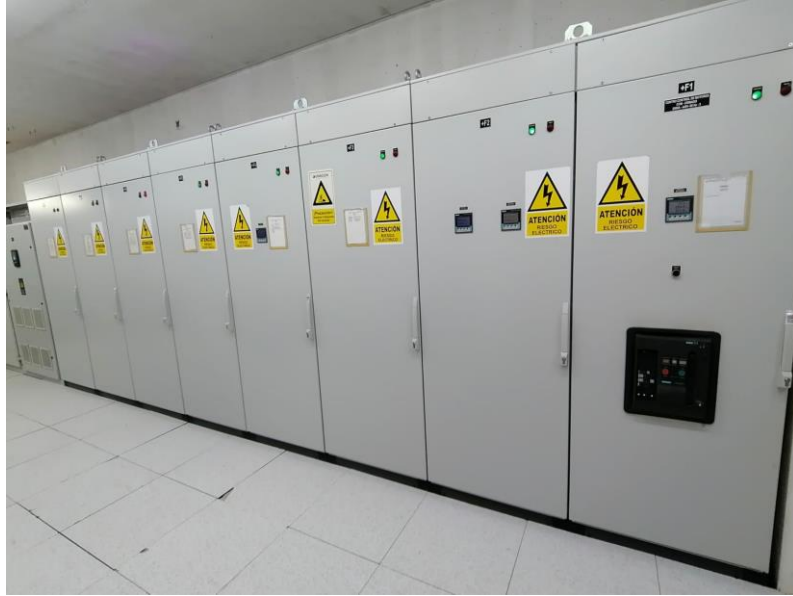
Figura 26: Tableros Auto soportados del CCM [CAROB Energy Perú]
