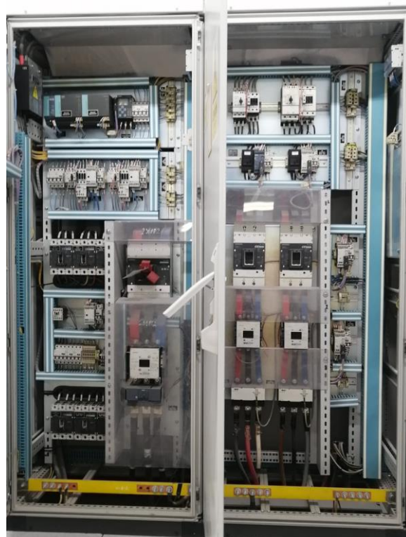
Figura 27: Disposición de los Equipos en los tableros del CCM [CAROB Energy Perú]
