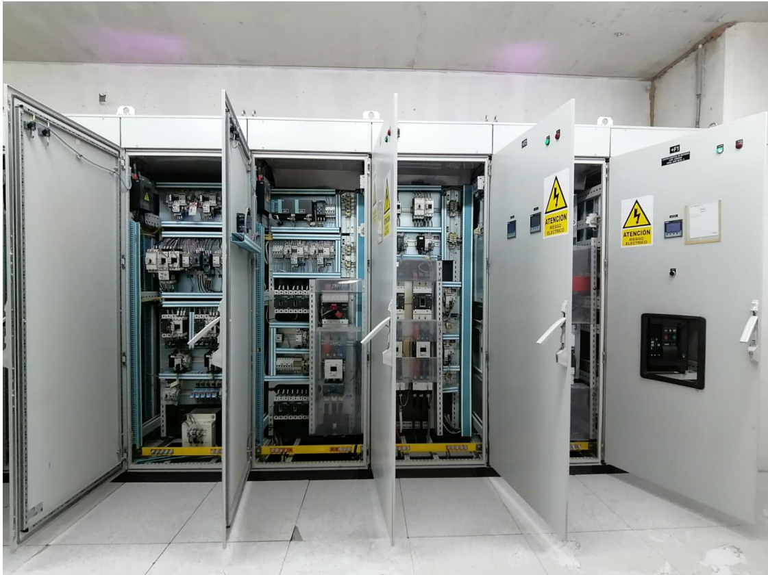
Figura 21 Centro de Control de Motores [CAROB Energy Perú]
