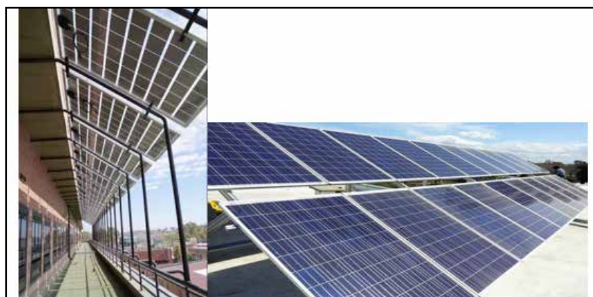
Figura 10: Sistemas FV instalados en el edificio TANDAR (CAC): (i) pérgola FV con 23 módulos de 215 W p , ubicada en el tercer piso del edificio (izquierda); (ii) 20 módulos FV de 240 W p , ubicados en la terraza (derecha).
