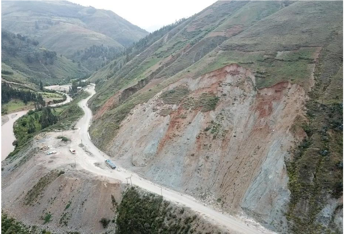
Ladera ubicada en el Km 180+300 de la ruta PE-3N – San Rafael
