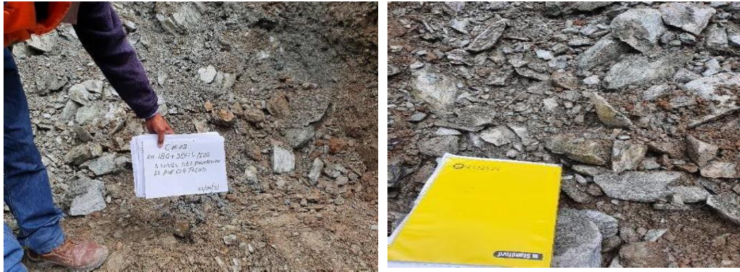
Vista de los estratos superiores (Material generado por sedimentación y deslizamiento del material superior del talud)
