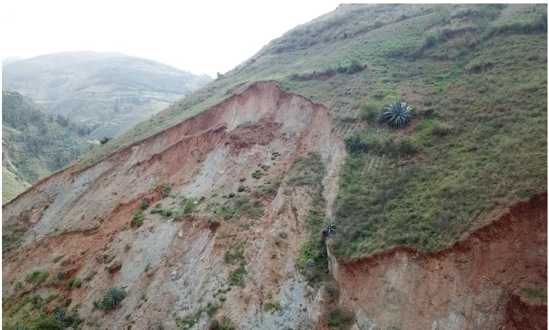
Presencia de grietas en la parte superior de la ladera
