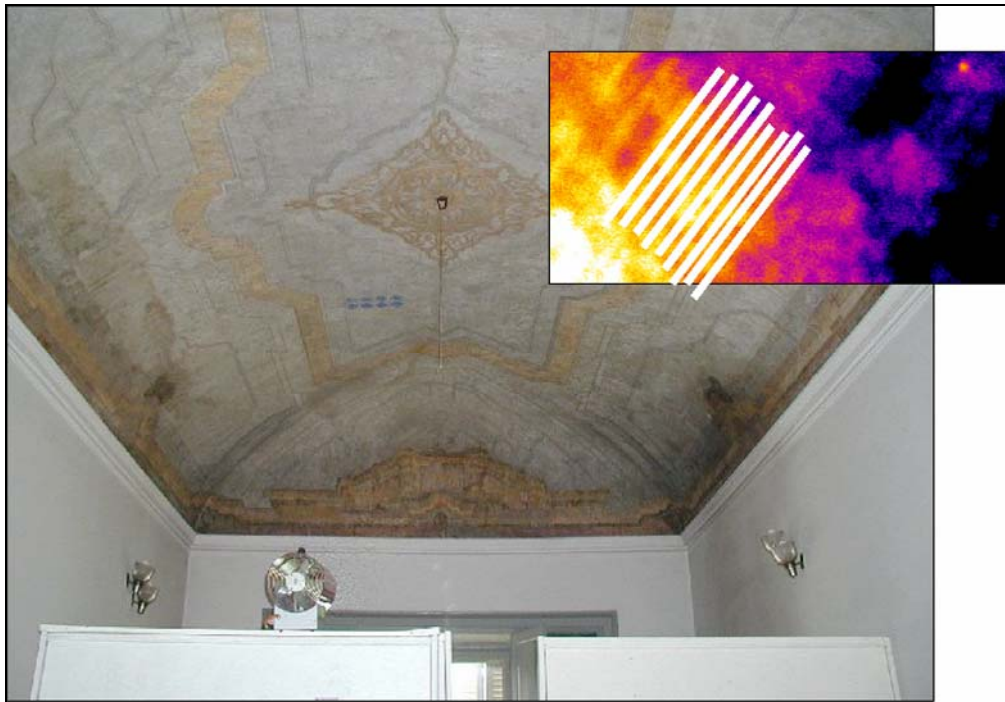
Fig. 12 - Ex refettorio. Termografia all'infrarosso termico che mette in evidenza la tessitura muraria e il piano d'imposta dei mattoni.
