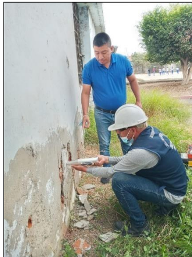
Figura 10. Ensayo de Esclerometría
