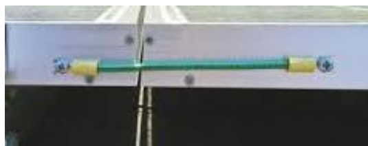
Figura 27. Deficiente conexión a tierra.
