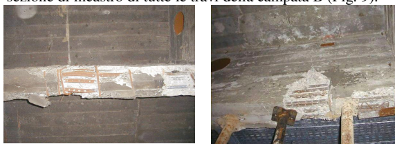
Fig. 7 - Esempi di danneggiamenti alle strutture in mezzeria delle travi, impalcato del 27° piano e 26° piano
