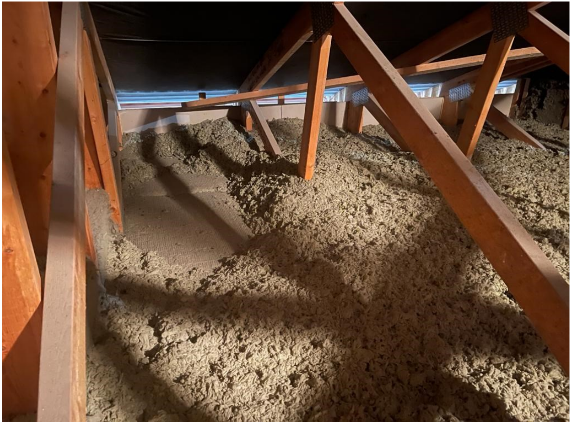
Kuva 5. Yläpohjaan päässeen tuulen vaikutuksesta eristeet ovat siirtyneet kokonaan osasta rakennetta.
