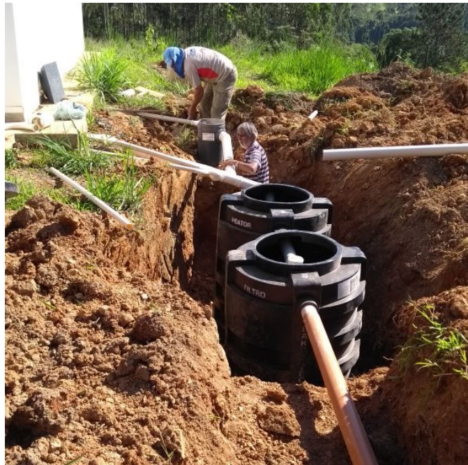
Figura 12 – Sistema de esgotamento sanitário na aldeia Figueira, José Boiteux.
