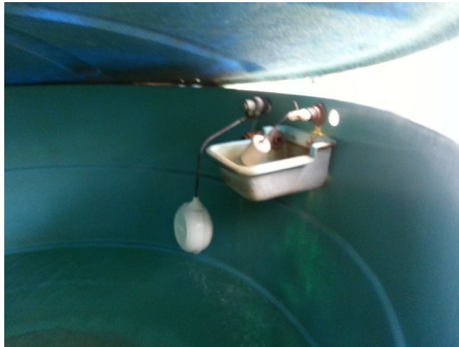
Figura 10 – Sistema de dosagem de cloro por gravidade na aldeia Amâncio, Biguaçu – SC
