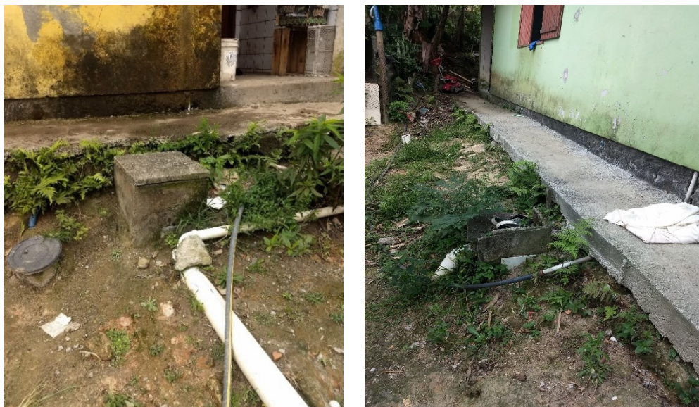
Figura 59 - Instalações de saneamento.
