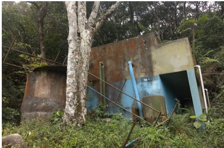
Figura 51 - Estação de Tratamento de água da aldeia Morro dos Cavalos.
