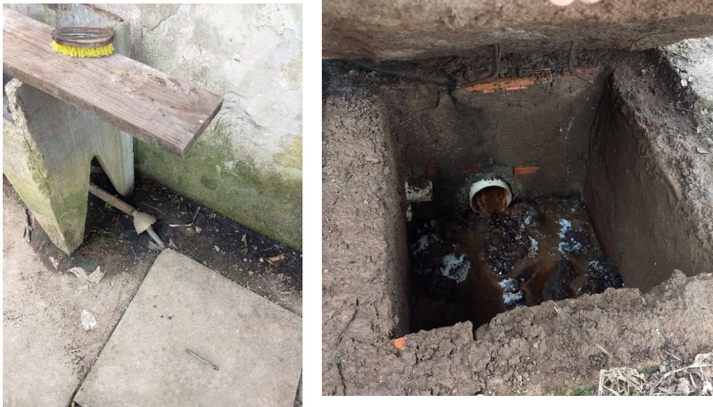
Figura 58 - Caixa de passagem de alvenaria.
