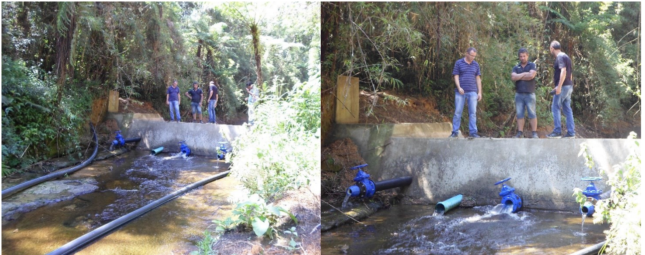
Figura 43 - Captação de água da aldeia Pavão – José Boiteux
