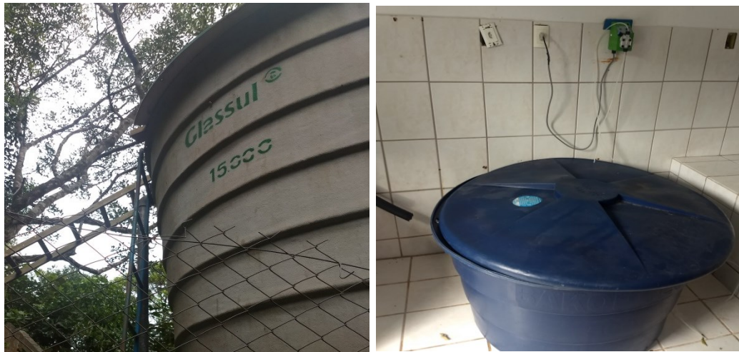
Figura 54 - Caixa de armazenamento da água; e Dosagem de cloro.
