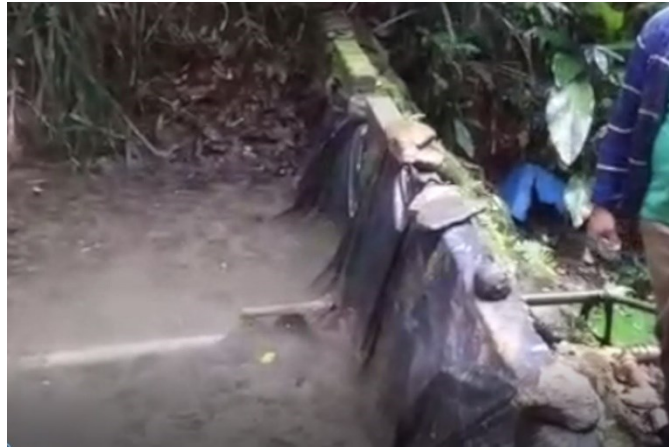
Figura 33 - Reservatório na aldeia Massiambú, Palhoça – SC.
