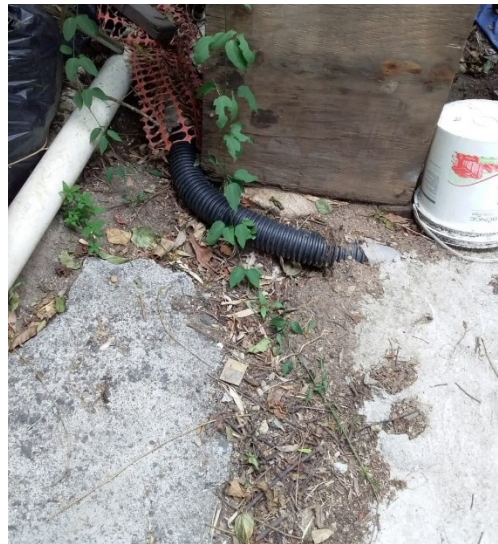
Figura 35 - Fossa séptica na comunidade Cambirela, Palhoça - SC.
