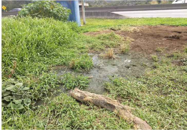
Figura 61 - Deposição de esgoto solo
