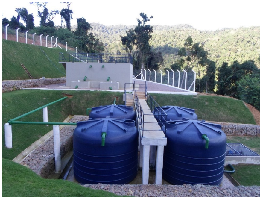
Figura 41 - Estação de tratamento de água na aldeia Pavão - José Boiteux
