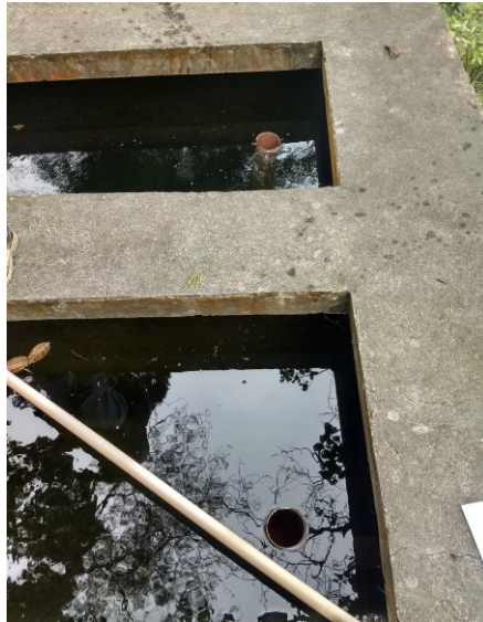
Figura 53 - Filtros do sistema de tratamento de água
