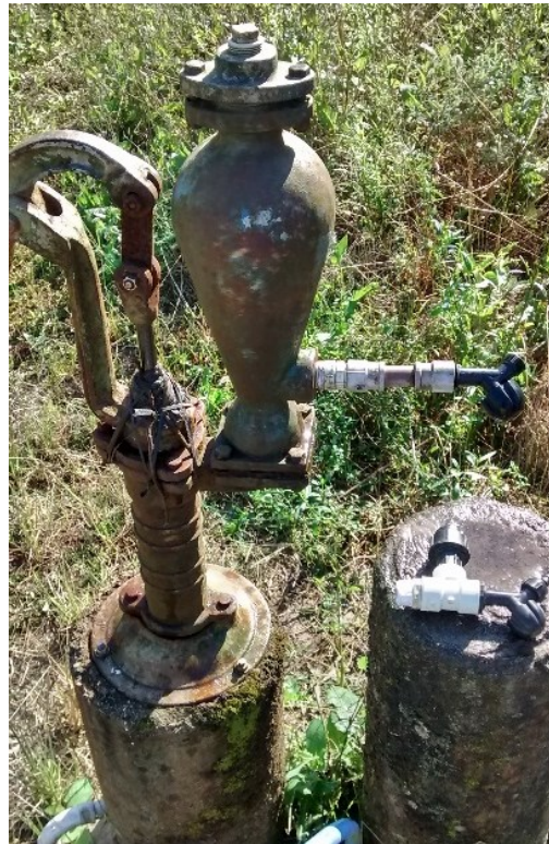
Figura 31- Bomba manual do sistema de abastecimento da Aldeia Tarumã Mirim, Araquari – SC.
