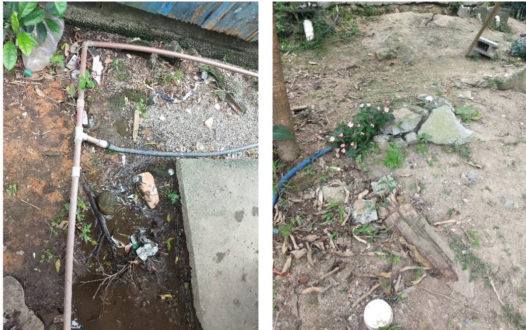
Figura 60 – Instalações de saneamento.
