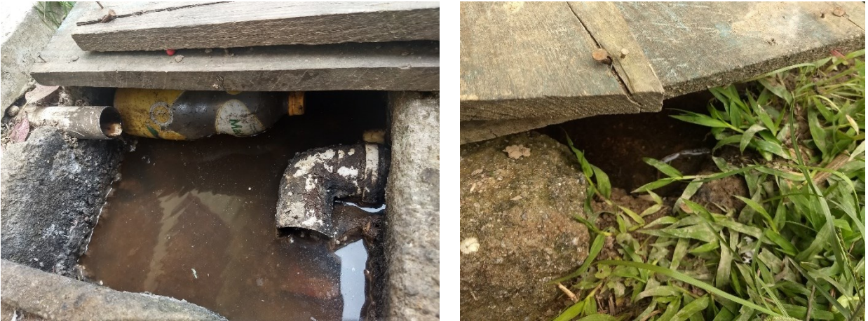
Figura 55 - Caixas de gordura
