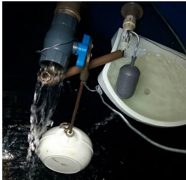
Figura 28 - Sistema de dosagem de cloro por gravidade na aldeia TEKOA WY`A, Major Gercino.
