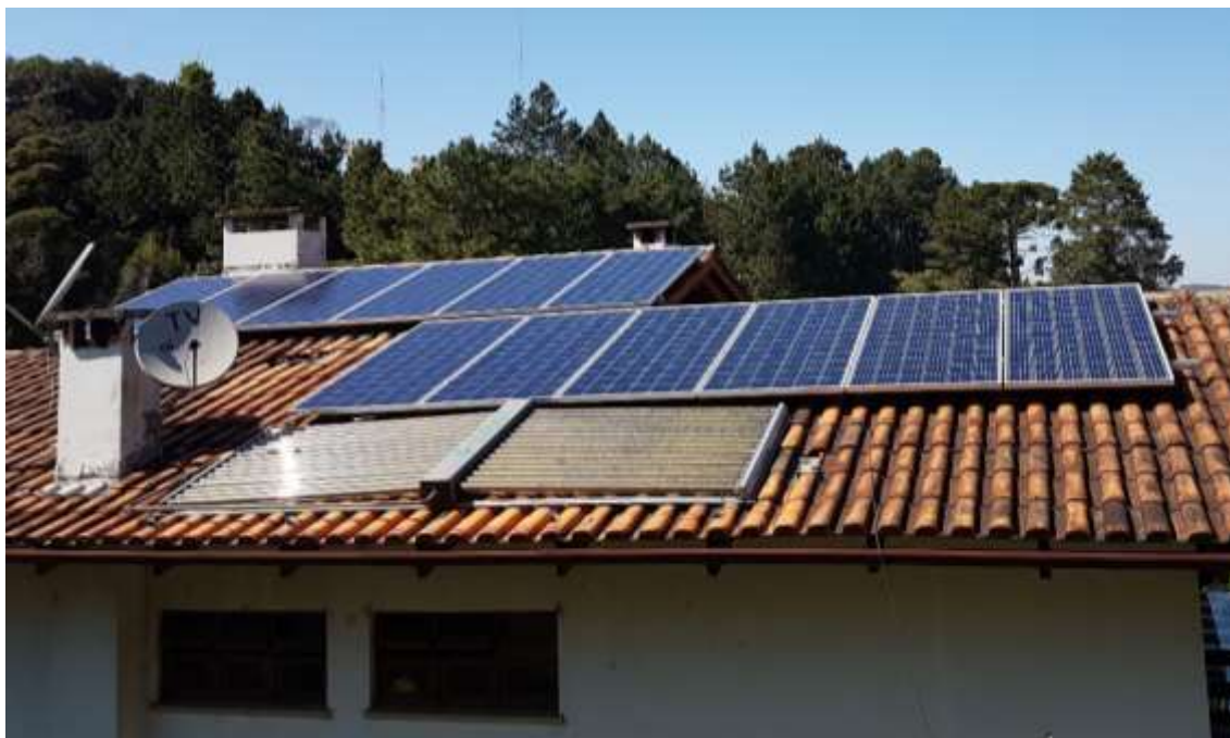
Figura 4 – SFCR 3 localizado em Rio Negrinho/SC.
