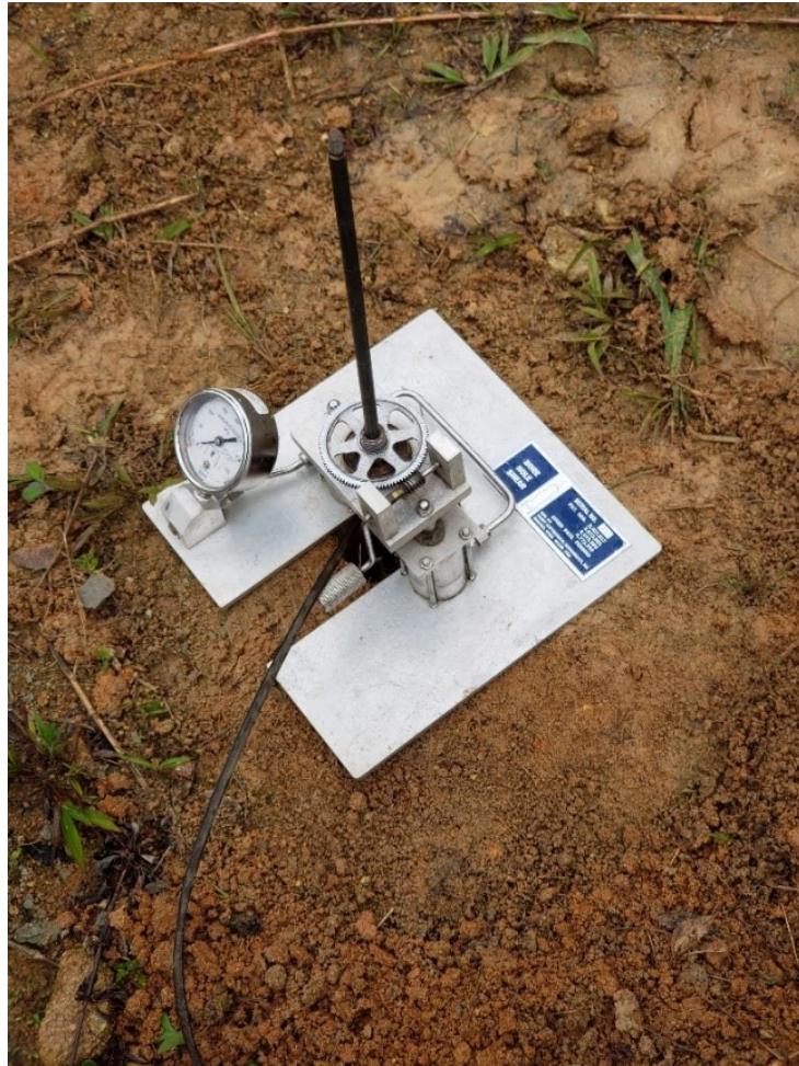
Figura 28 – Equipamento devidamente instalado
