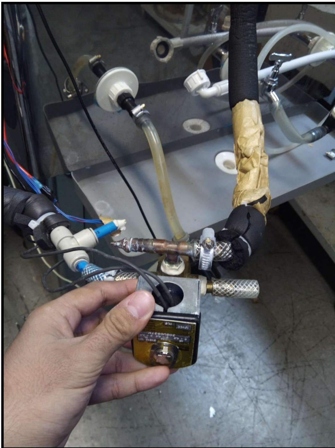
Figura 63-Foto da válvula três vias (SV03).
