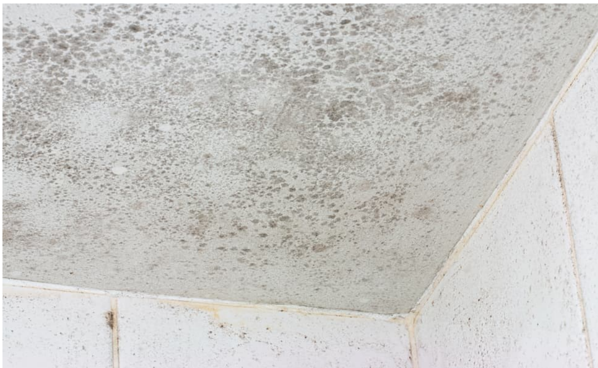
Figura 09 - Manchas por condensação de vapor d'água
