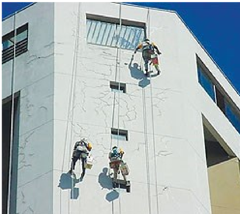
Figura 04 - Fissuras mapeadas devido à retração da argamassa
