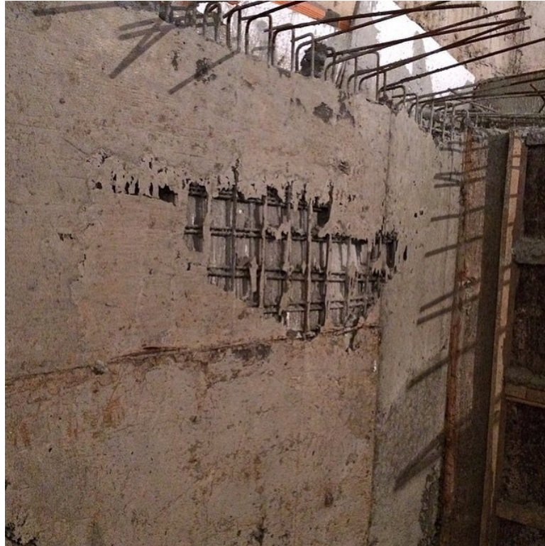
Figura 12 - Bicheira, ou broca, em estrutura de concreto armado
