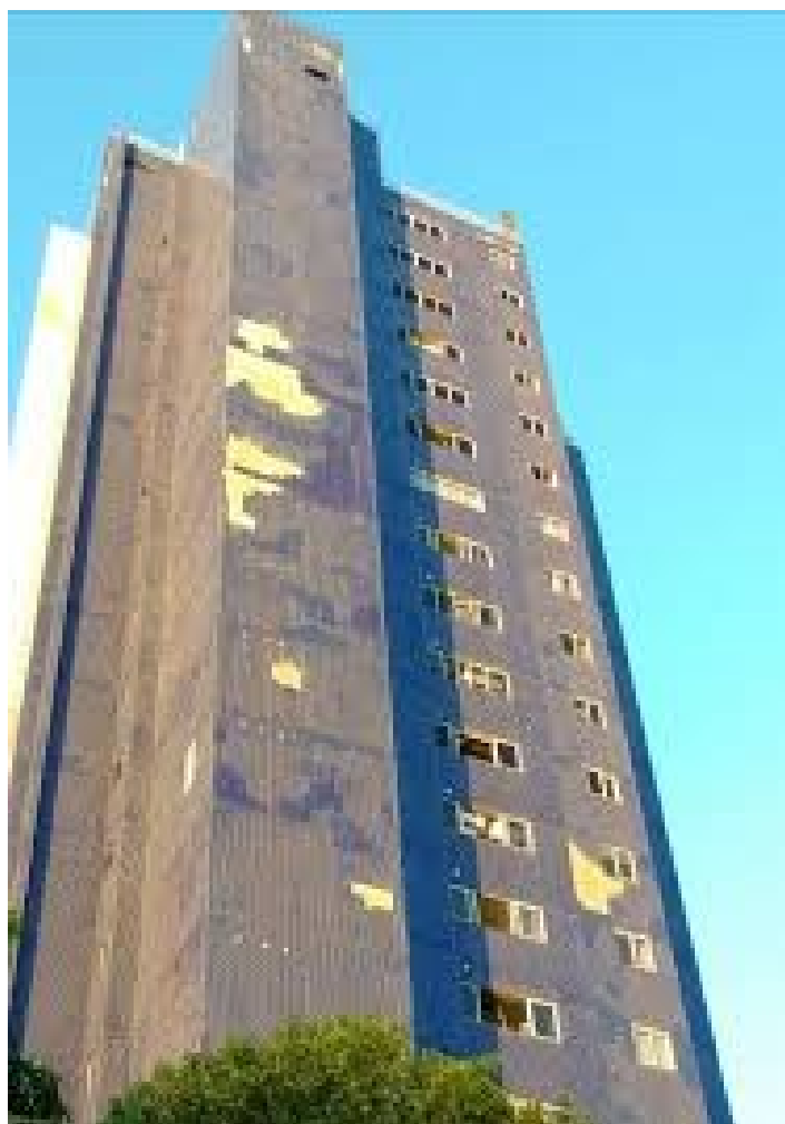
Figura 11 - Deslocamento de revestimento cerâmico na fachada de uma edificação
