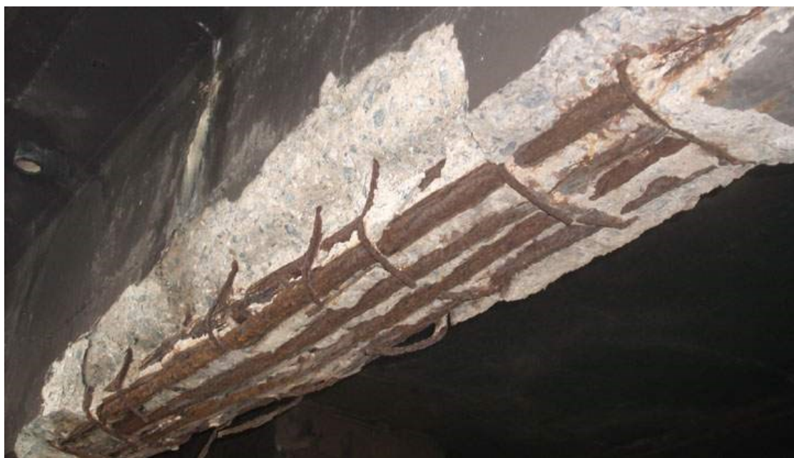
Figura 14 - Corrosão da armadura de uma viga
