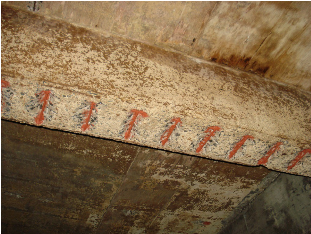
Figura 13 - Cobrimento insuficiente em viga
