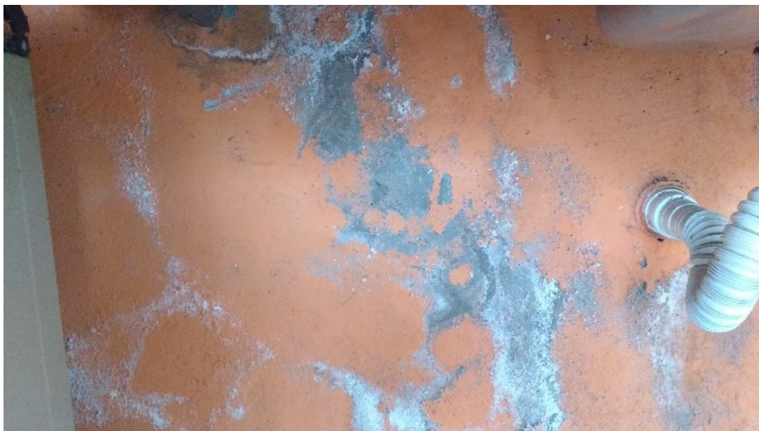
Figura 10 - Eflorescência na edificação
