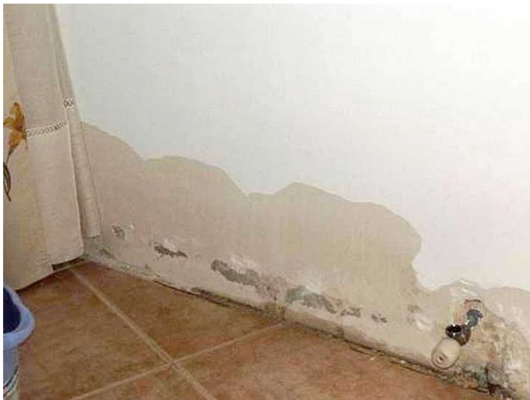
Figura 08 - Mancha por capilaridade
