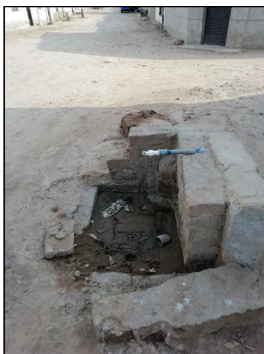
Figura 28. Piletas públicas en mal estado
