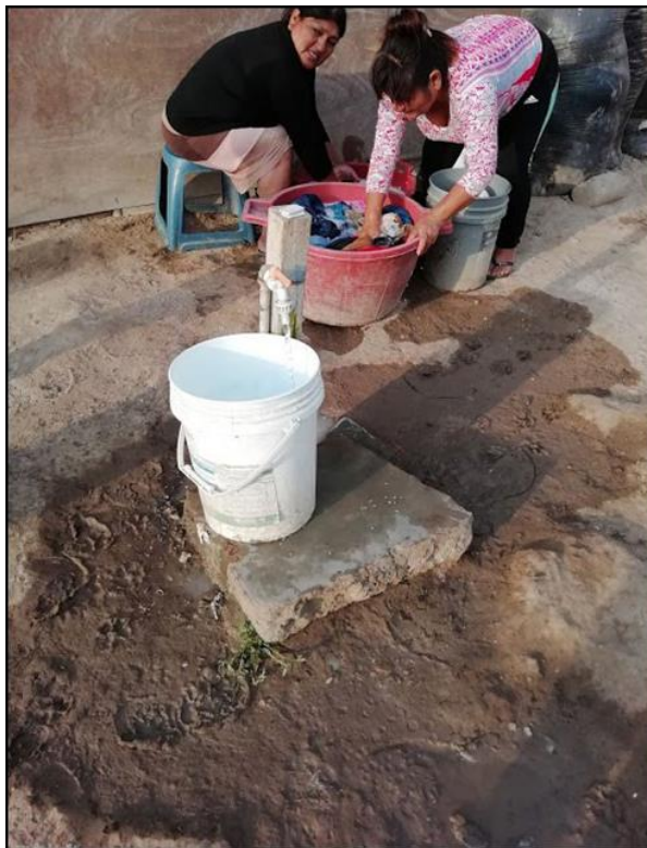
Figura 29. Conexiones clandestinas – Asentamiento Humano “Los Arenales”
