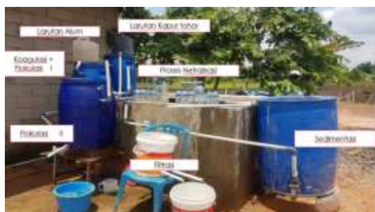
Gambar 6. Instalasi peralatan proses pengolahan air gambut
