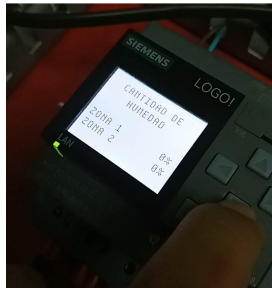
Pantalla de la cantidad de humedad.
