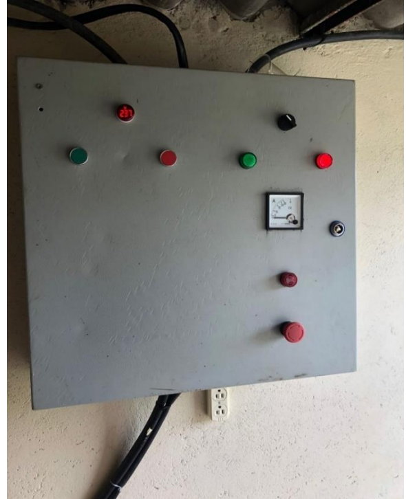
Ubicación de pulsadores, luces piloto, amperímetro y selector en la parte exterior del tablero de control.
