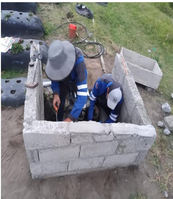
Ubicación de la manguera para la protección de conexiones eléctricas.
