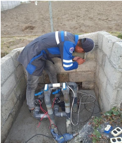
Conexión de las electroválvulas.
