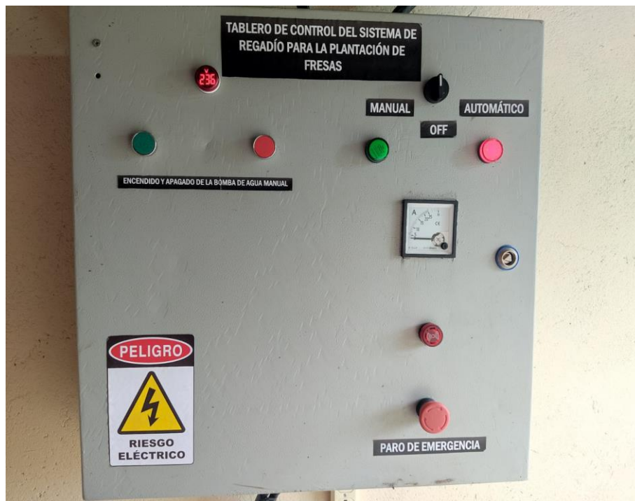
Ubicación de señalética en el tablero de control.
