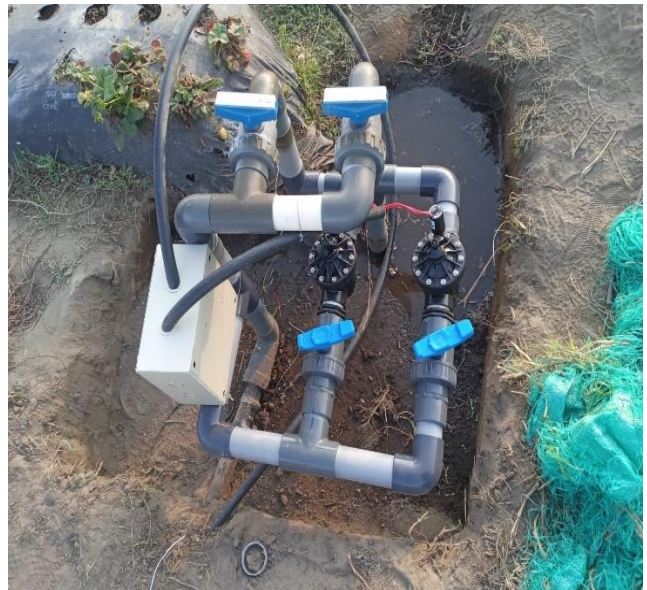
Electroválvulas Zona 1 y 2.
