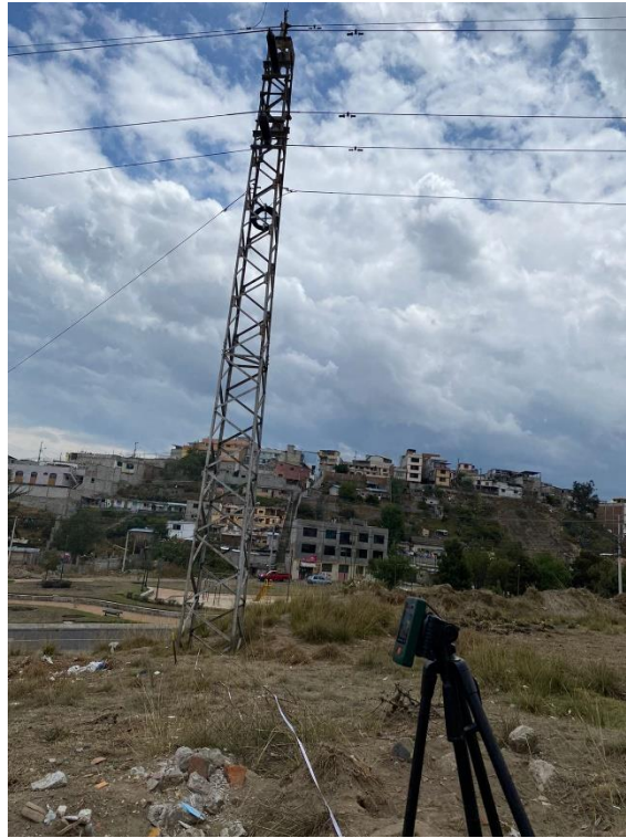
Figura D.15. Toma de datos perfil lateral lado izquierdo Torre E-0268.
