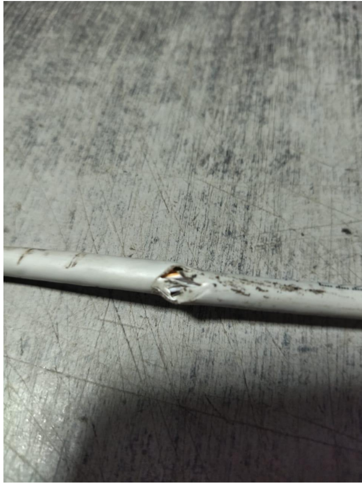
Figura 10.4 Estado del cableado categoría 5E
