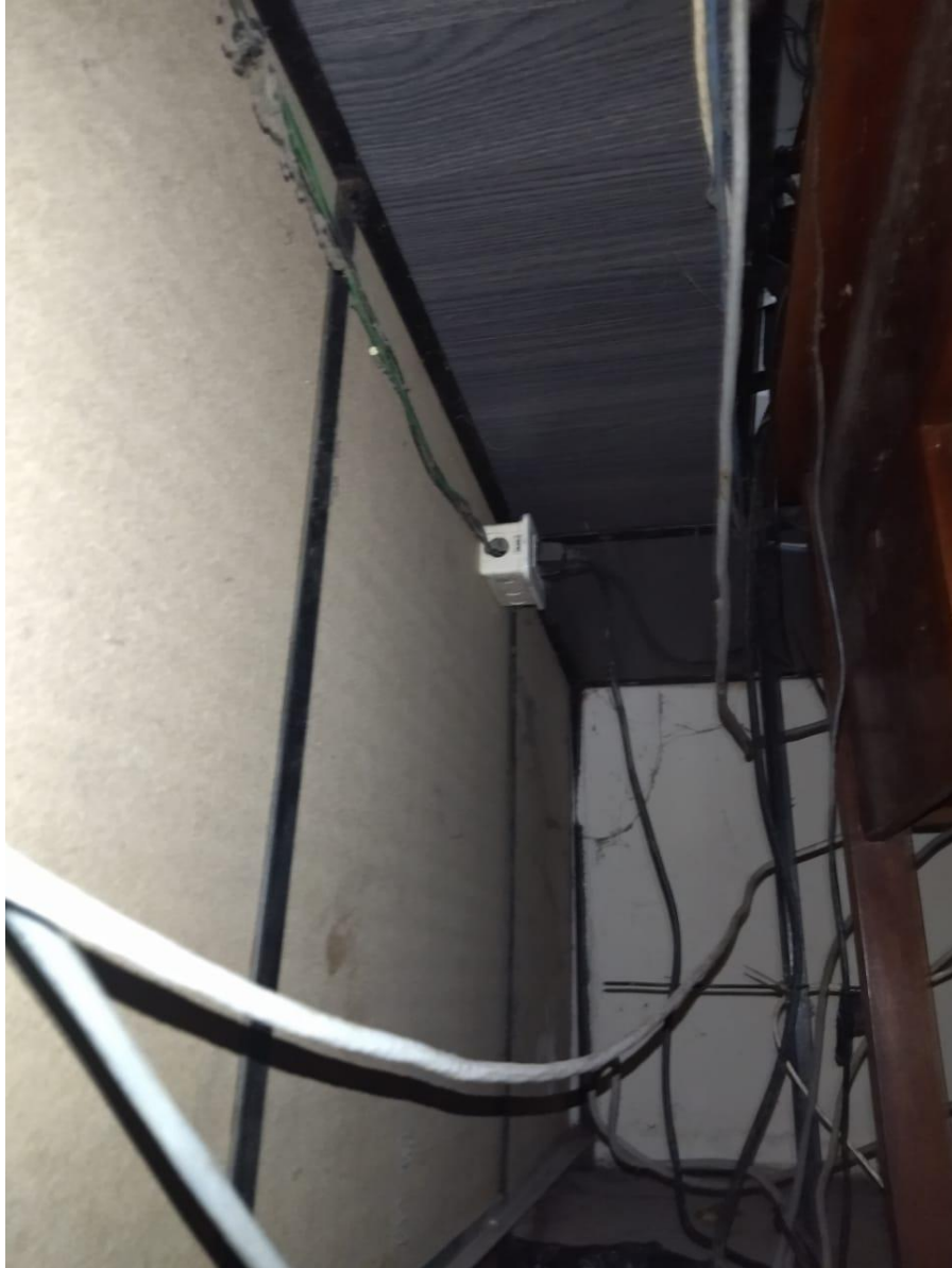
Figura 10.6 Estructura del cableado sin canaletas.
