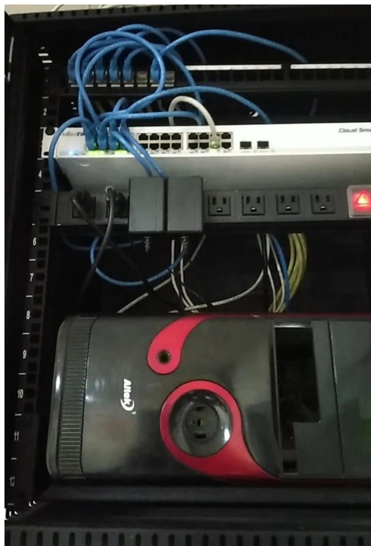
Figura 10.12 Estructura del rack y switch administrable.
